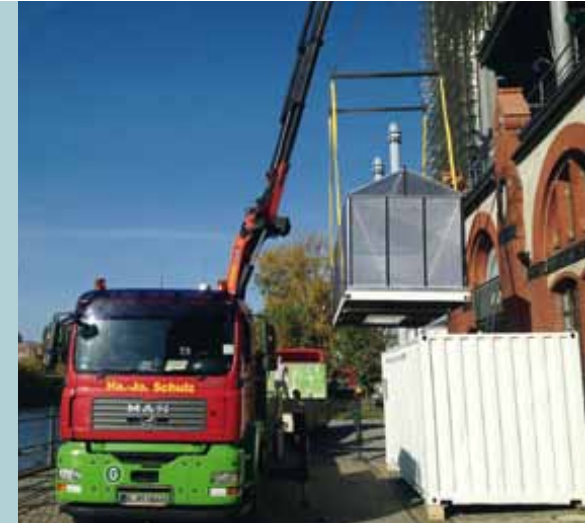
Aufbau der ECF Containerfarm auf dem Gelände der Malzfabrik in Berlin, ECF | Efficient City Farming Berlin
