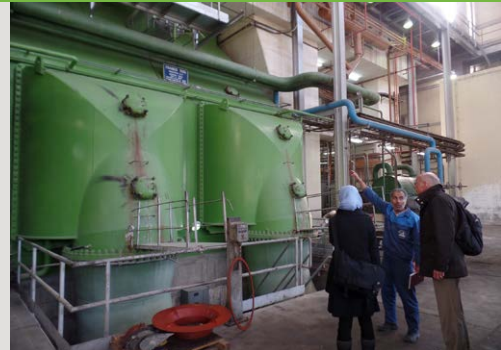
بازدید از نیروگاه برق اصفهان
