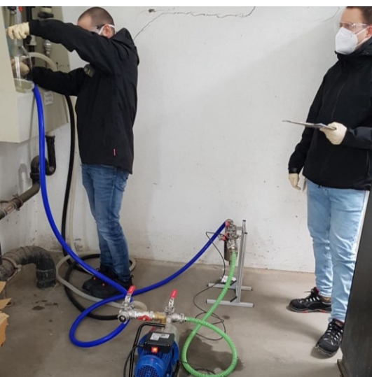
Abbildung 12: Probenahme mit saugseitigem Edelstahlkerzenfilter und Mischprobe für Begleitparameter
