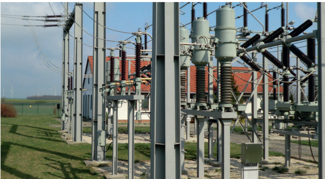
Abbildung 1: Umspannanlage als Beispiel für eine Komponente Kritischer Infrastrukturen
