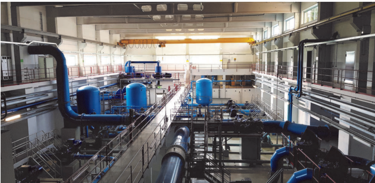
Abbildung 8: Prozesse in Wasserwerken sind von vielfachen externen Ressourcen abhängig
